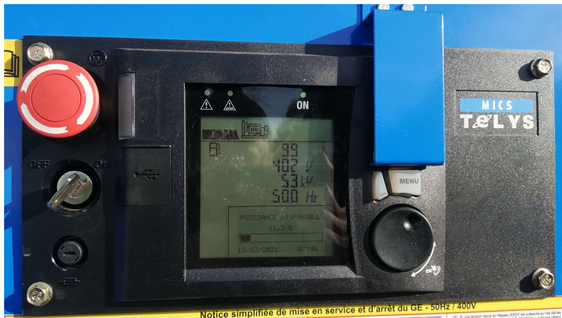
Résultat de puissance mesurée lors de test de groupes électrogènes
