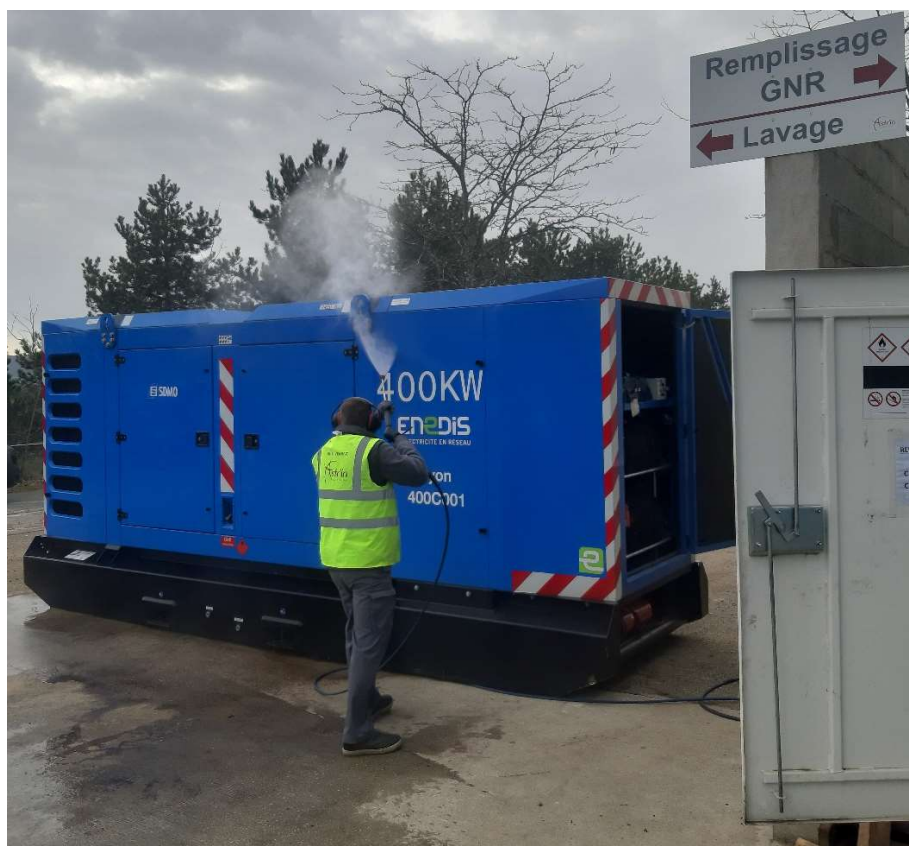
Aire de lavage de groupes électrogènes sur une installation similaire
