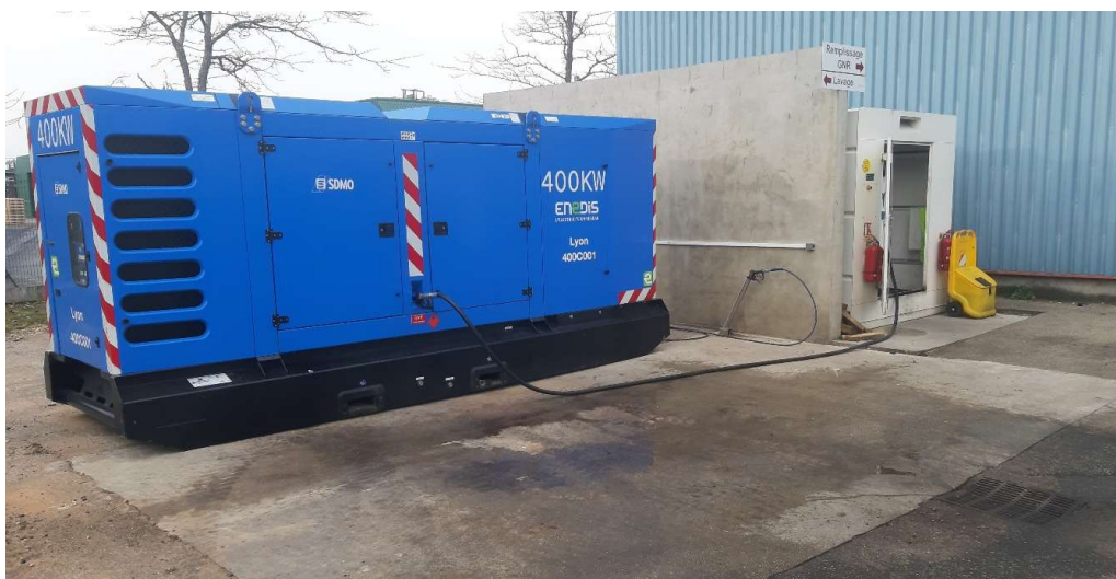
Remplissage en GNR d'un groupe électrogène sur un site similaire
